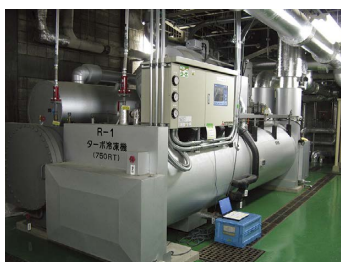
▲ターボ冷凍機
